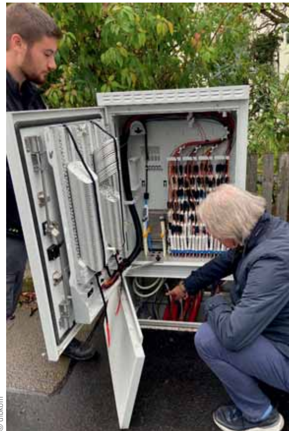
Beim Ausbau der Netzebene 4 zwischen Netzverteiler und Hausanschluss ist nicht nur technisches Verständnis gefragt, sondern auch Projektmanagement und rechtssichere Steuerung. All dies vermittelt das neue Kursangebot der dibkom.
